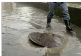
マンホール蓋外れ
