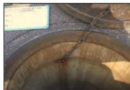
蝶番のないマンホール蓋
