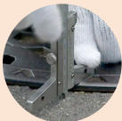
周辺舗装との段差
