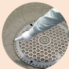
周辺舗装の損傷
