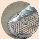
周辺舗装の損傷
