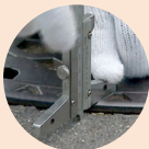
周辺舗装との段差
